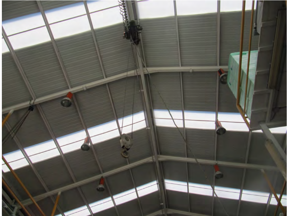
Grúa puente monocarril en el taller. INVASSAT
