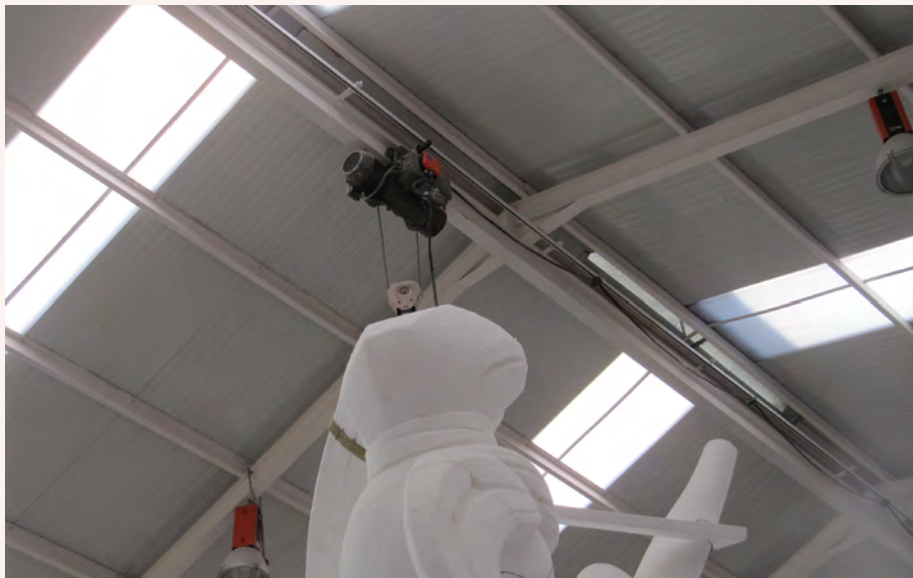
Puente grúa monorraíl utilizado en el taller. INVASSAT
