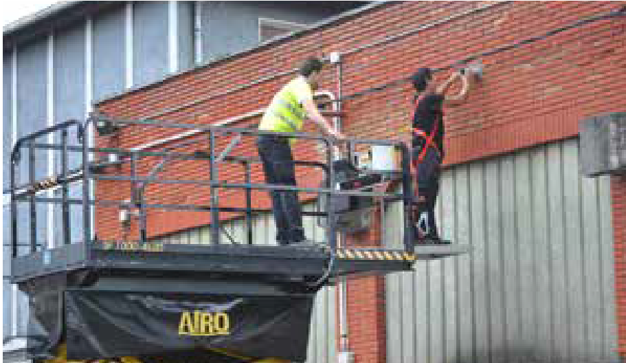
Plataforma de PEMP con superficie indebidamente aumentada para acceso. Fuente: INSHT. NTP 1039: Plataformas elevadoras móviles de personal (I): gestión preventiva para su uso seguro
