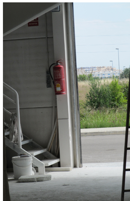
Los extintores no deben disponerse directamente sobre el suelo y deben ser accesibles. INVASSAT
