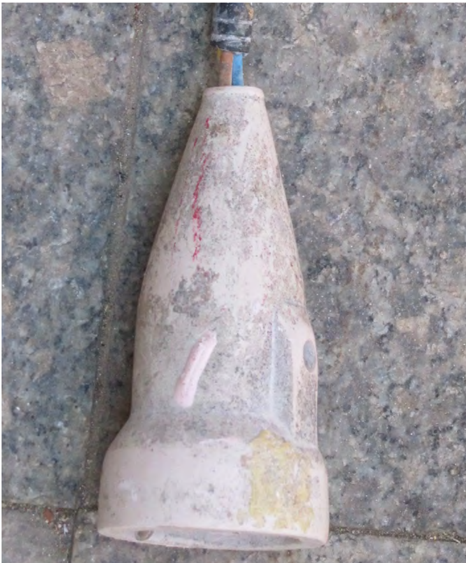
Toma de corriente que ha perdido su grado de protección. INVASSAT
