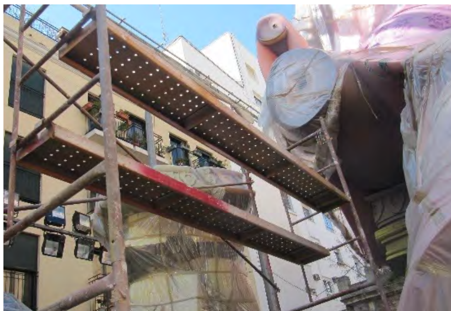
Andamio NO adecuado. INVASSAT
