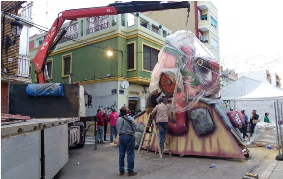
Personas ajenas a los trabajos bajo la zona de influencia de la grúa. Fuente: Iván Esbrí. Gremio de artistas falleros de Valencia
