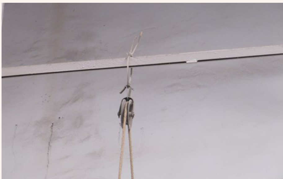
Polea simple deficientemente sustentada en taller fallero y "foguero". INVASSAT
