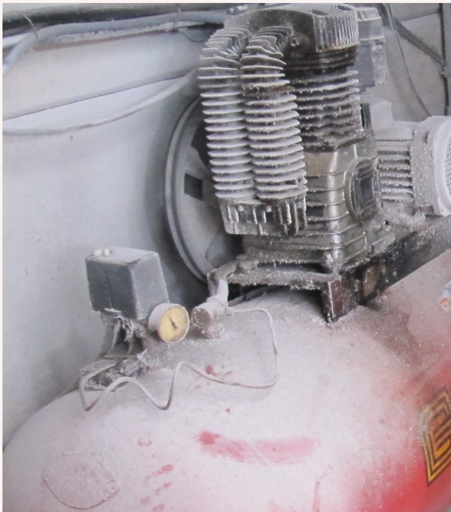
Válvula de seguridad y presostato. INVASSAT
