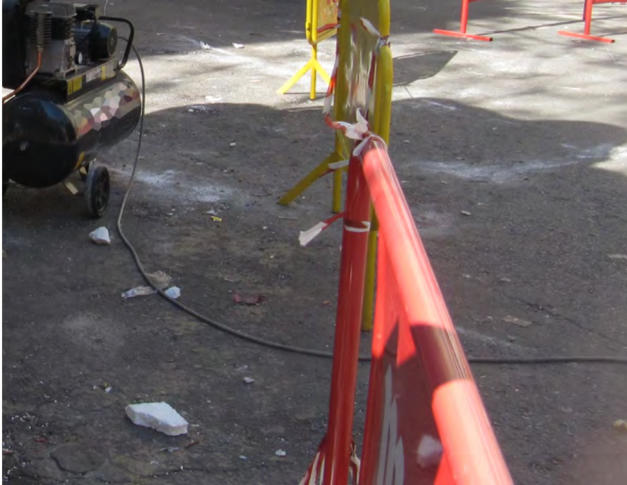
Ejemplo de manguera de conductores de alimentación del compresor tendido por el suelo sin ningún tipo de protección mecánica. INVASSAT
