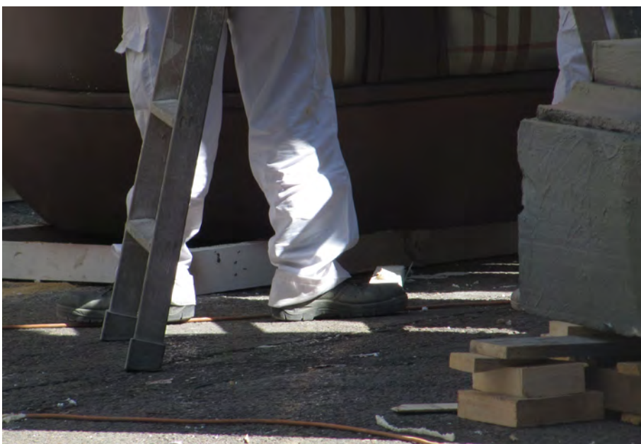
Utilización de calzado de seguridad. INVASSAT
