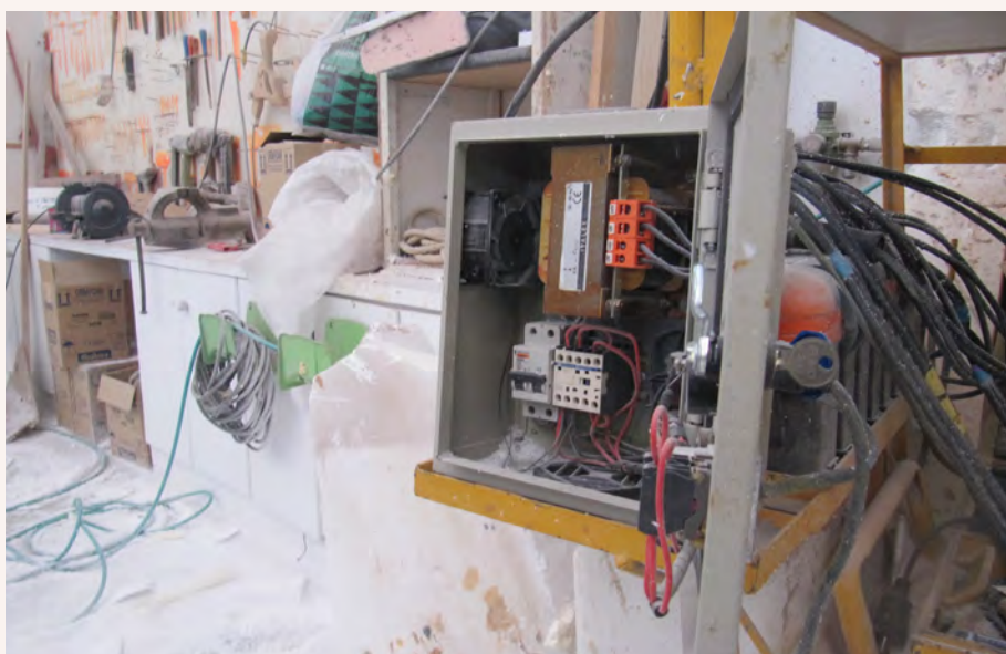
Cuadro eléctrico abierto en el que se generan zonas de peligro alrededor de sus elementos activos. INVASSAT
