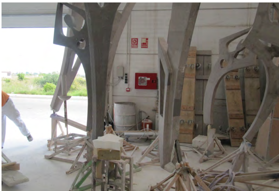
BIE situada en la salida del sector de incendio, pero muy obstaculizada. INVASSAT
