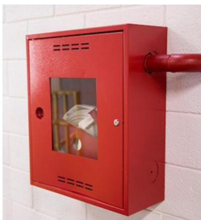
Boca de incendio equipada (BIE). Fuente: libre
