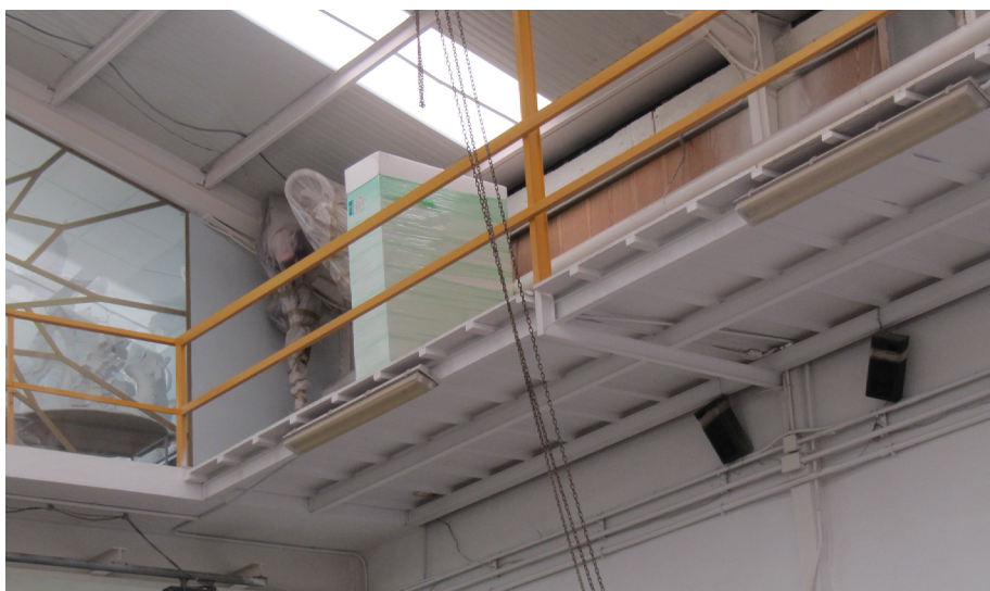
Protección mediante barandilla de un altillo en un taller. INVASSAT
