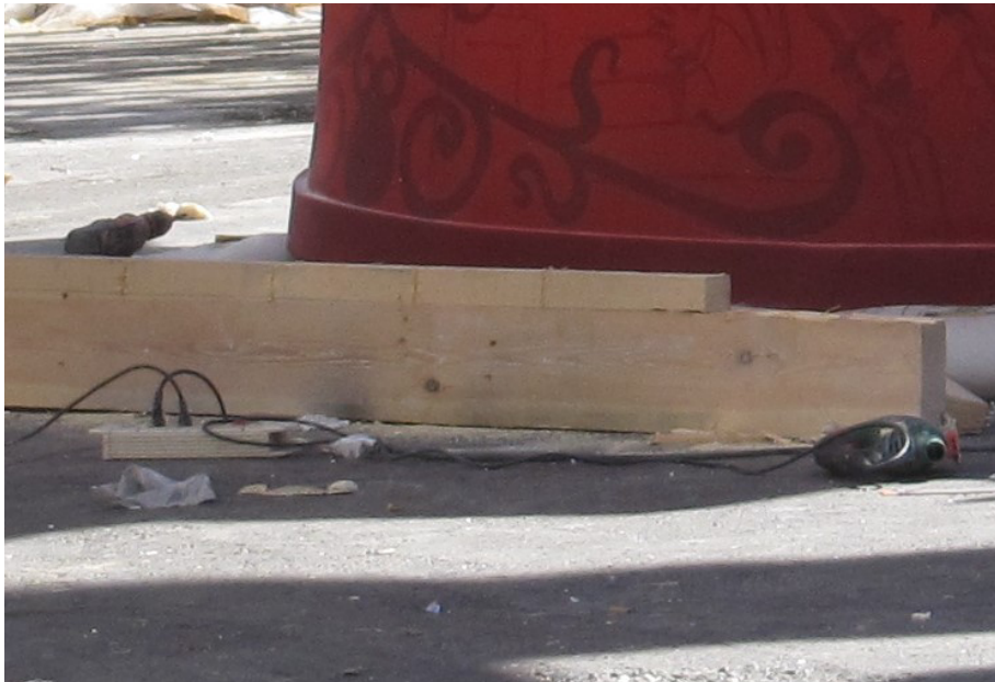
Utilización de alargadera doméstica para alimentar a una lijadora y a una taladradora eléctrica. INVASSAT
