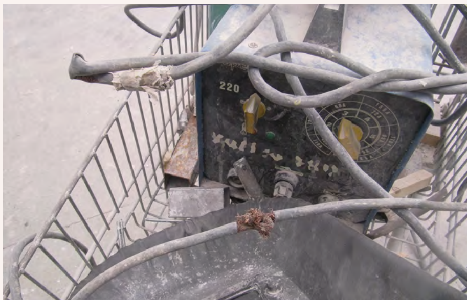
Cables de soldeo y masa defectuosos. Han perdido su aislamiento. INVASSAT
