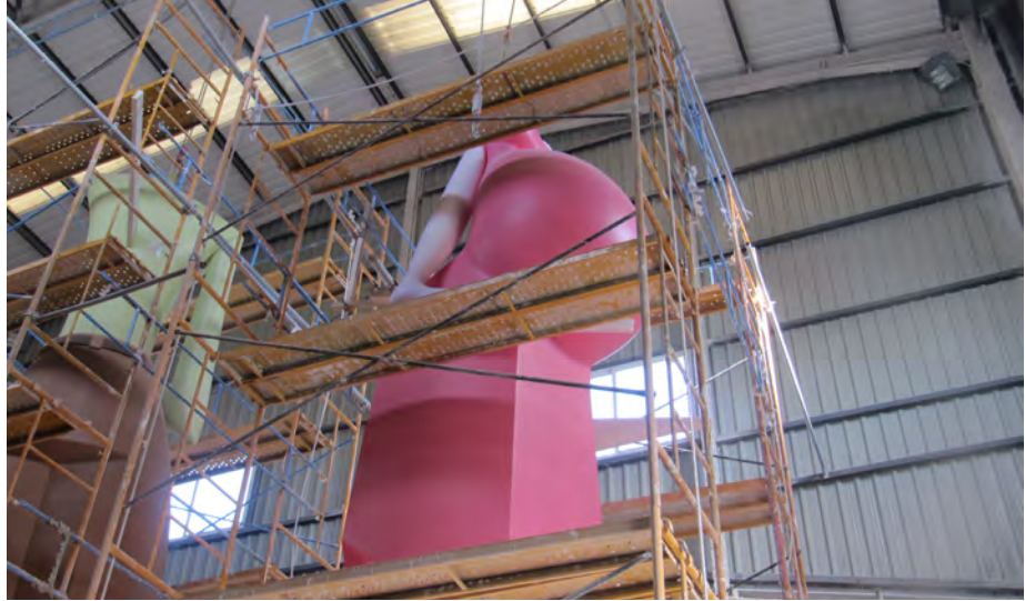
Andamio que no tiene cuajada su plataforma de trabajo y por tanto existe riesgo de caída por hueco de plataforma. INVASSAT
